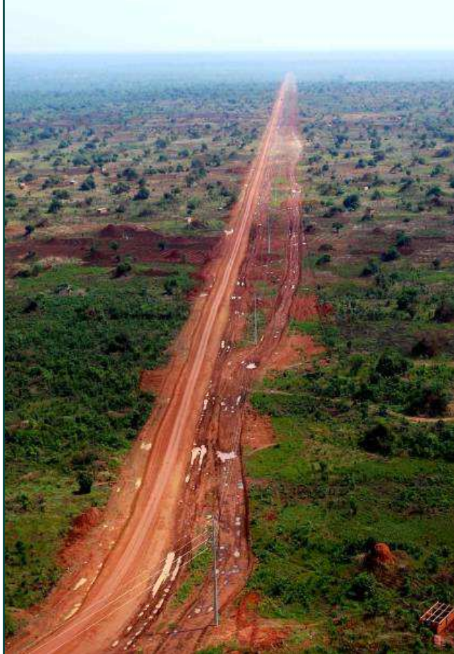
Ligne de transmission hydro- électrique de 120kv et route d'accès de 40km
