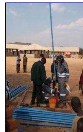
Tuyauterie pour l'eau potable
